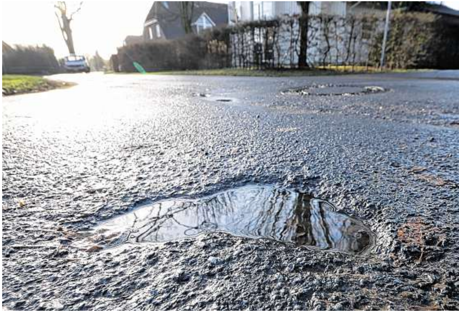
Viele Straßen in der Gemeinde Riede müssten dringend saniert werden. Doch für die Instandsetzung sind im kommenden Haushaltsjahr nur wenig Gelder vorgesehen. FOTO: FOCKE STRANGMANN
